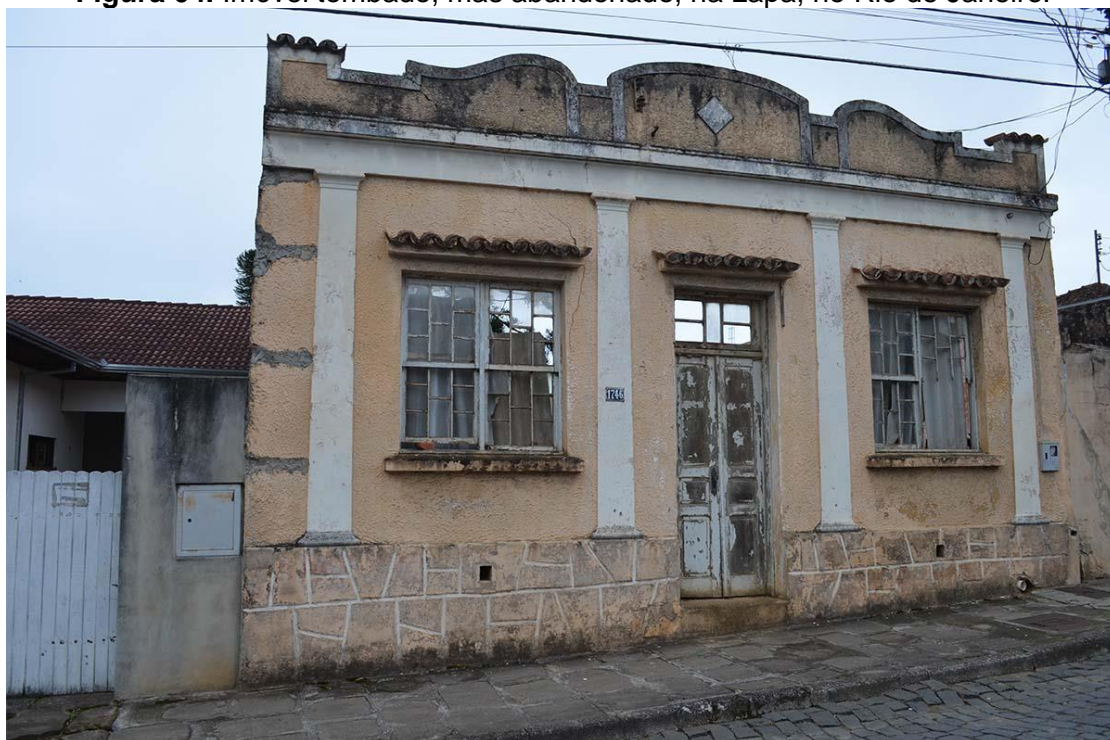
Figura 04. Imóvel tombado, mas abandonado, na Lapa, no Rio de Janeiro.
