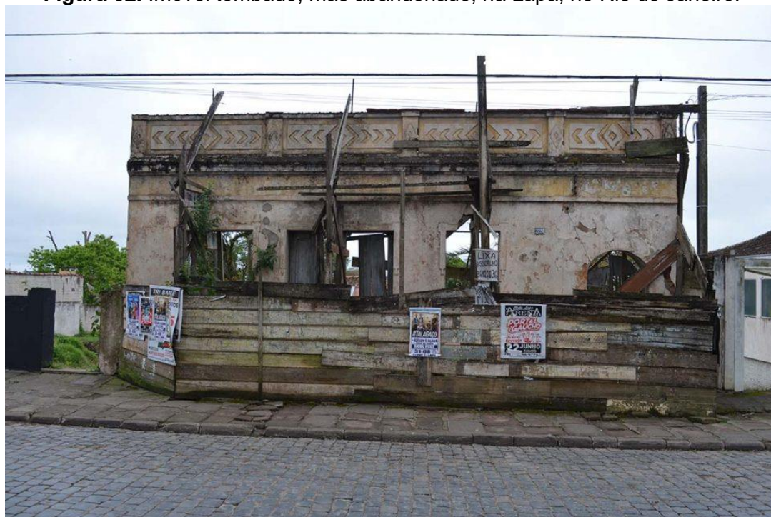
Figura 02. Imóvel tombado, mas abandonado, na Lapa, no Rio de Janeiro.
